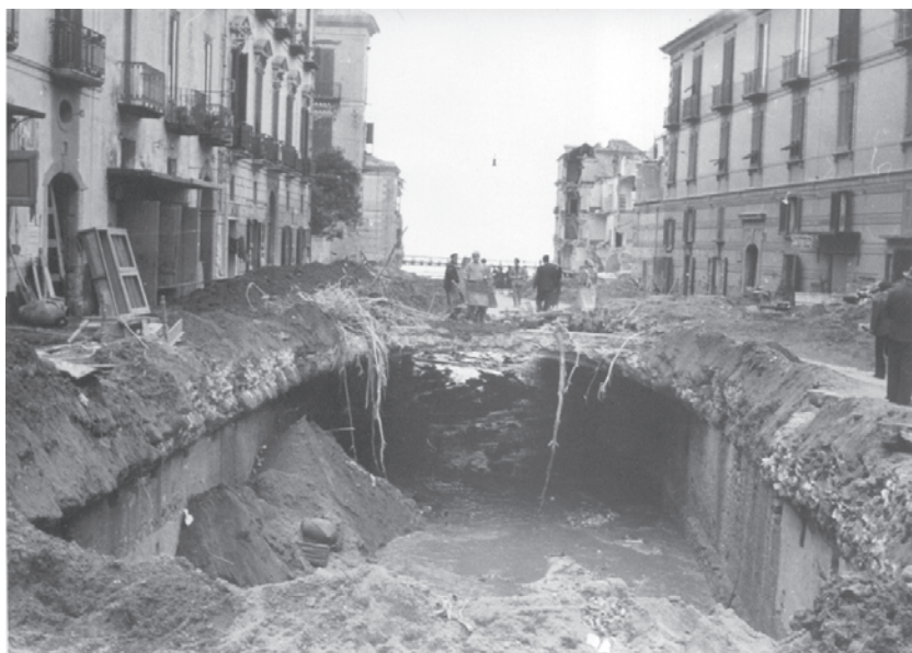
Figura 1.4 - Maiori, completo sfondamento della copertura del canale che raccoglieva le acque del Torrente Regina Maior (Foto del Servizio Idrografico e Mareografico di Napoli, 1954).
